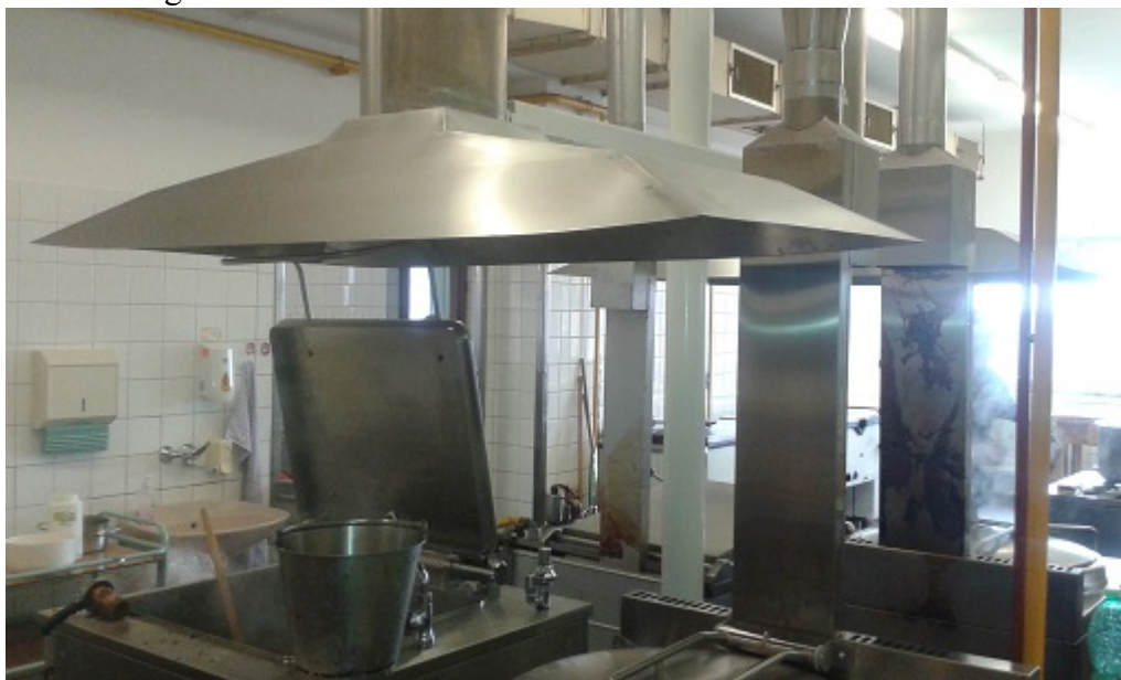
Obr. č.4 Digestoř
